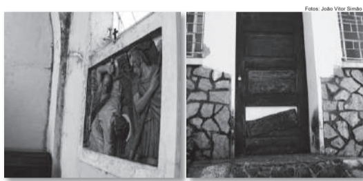
INFILTRAÇÕES danificam painéis e porta
