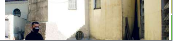
MOFO, INFILTRAÇÕES E PROBLEMAS ESTRUTURAIS AMEAÇAM IGREJA SÃO JOSÉ OPERÁRIO
