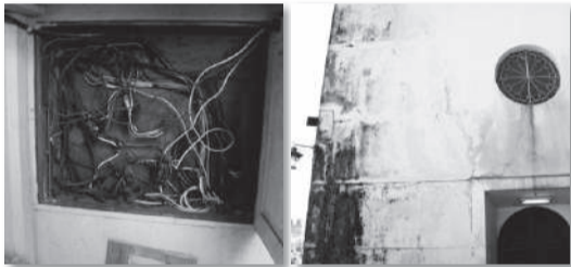
INSTALAÇÃO elétrica antiga é risco e mofo toma conta
