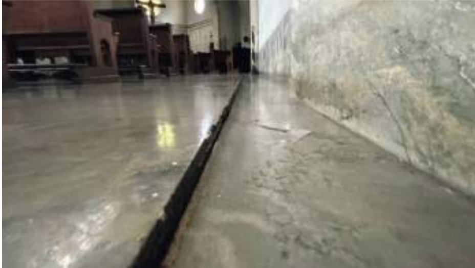
O INTERIOR da igreja já têm desnível visível devido a movimentação do solo
